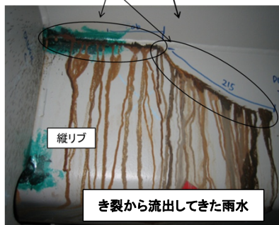
疲労き裂 厚さ12mmのデッキプレート （舗装下面）
