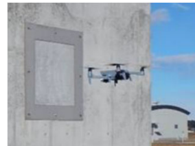
ドローンによる損傷把握
